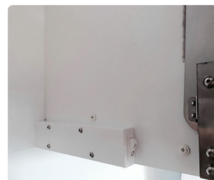
6. Inbyggd strömställare för LED-belysningen.
